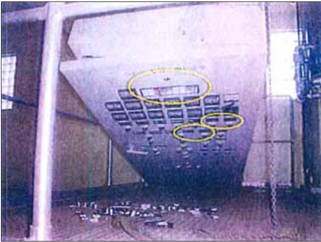
写真 - 1 地震動による非常通報装置（壁掛型）固定部の破損（東北地方太平洋沖地震）
