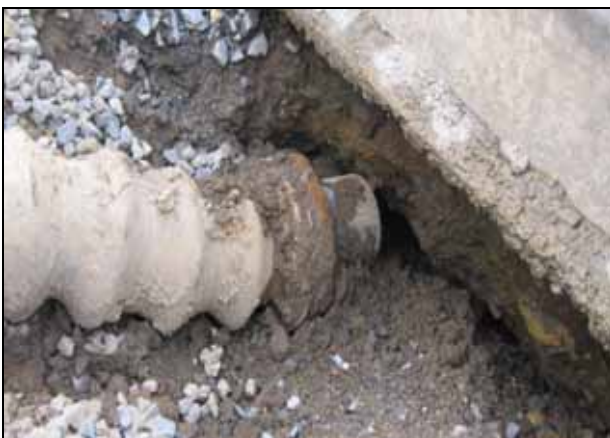
写真 - 3 地震動（液状化現象）による流入管等の破損（東北地方太平洋沖地震）
