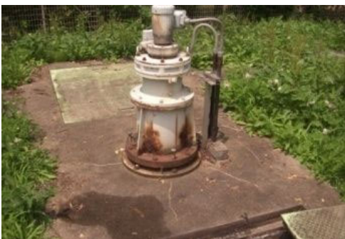
機械設備の発錆・腐食
