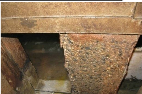
コンクリートの粗骨材の露出、部分的な剝離
