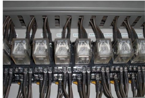
盤内のケーブルや接点の変色・劣化
