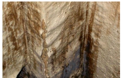
水槽の防食被覆のふくれ、剥がれ
