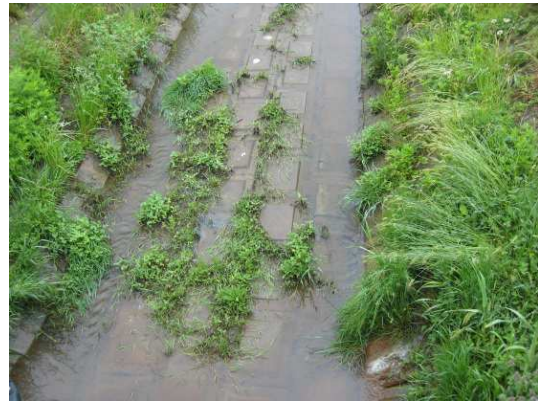
コンクリートパネルの継ぎ目から生えてくる雑草は、しぶとく手強い。とくに地下茎で繁殖する雑草は、農家泣かせの一言に尽きる。
