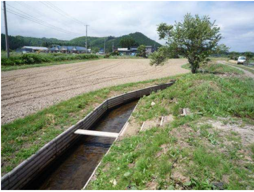
写真3 周辺の耕作者に配慮した付帯施設 事前に周辺の耕作者の意向を把握し、使い勝手のよい洗い場を設置（外）。
