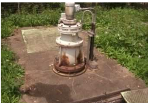
機械設備の発錆・腐食
