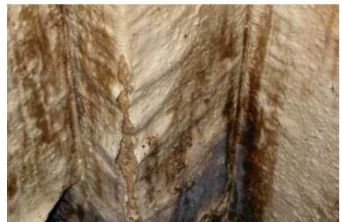
水槽の防食被覆のふくれ、剥がれ
