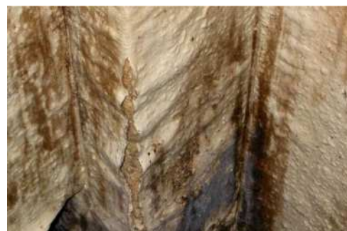
水槽の防食被覆のふくれ、剥がれ
