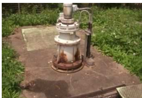
機械設備の発錆・腐食
