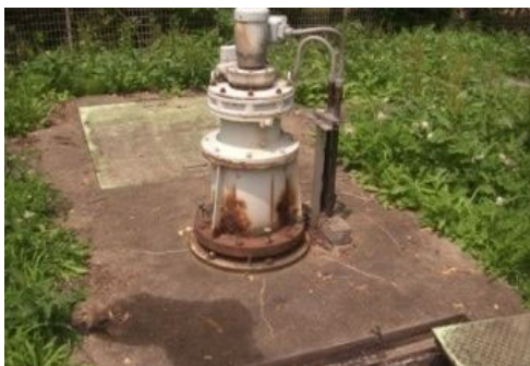
機械設備の発錆・腐食
