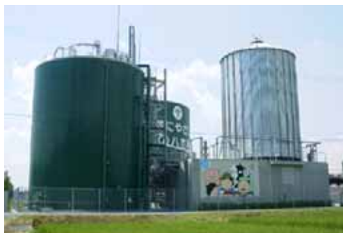
写真 3-1 メタン発酵槽（左）ガスホルダー（右）
