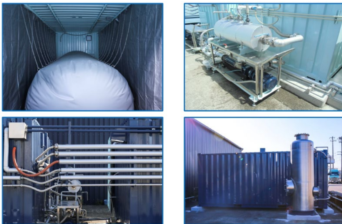
写真 6.7.3 メタン発酵施設状況（左上 メタンバルーン、右下 脱硫装置）
