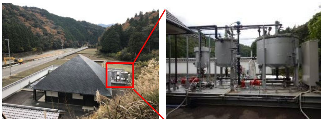
写真 6.1.1 現地メタン発酵施設（徳島県佐那河内村）
