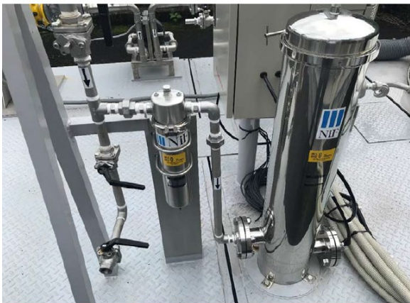
写真 6. 2. 12 右 : 脱硫塔、左 : ミストセパレーター
