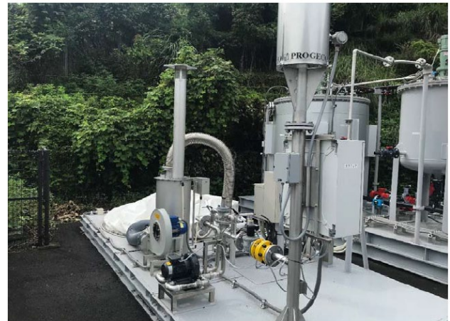
写真 6.2.9 ガスホルダーユニット
