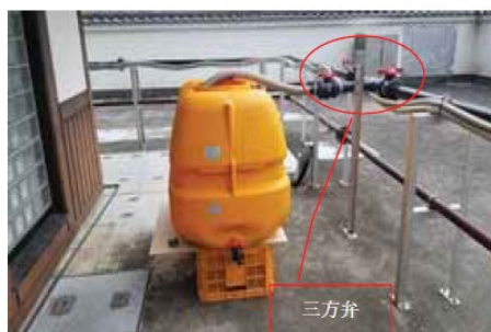
写真 6.2.18 三方弁と汚泥貯留槽
