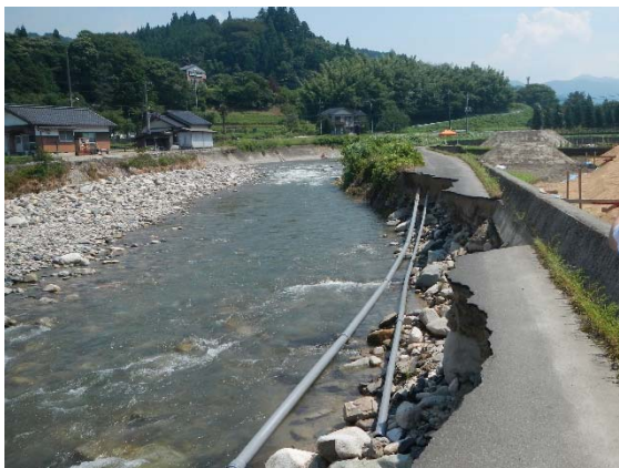
河川護岸洗堀による管路破損
