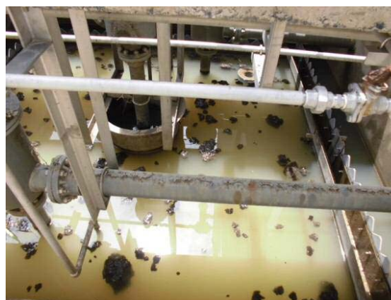
沈殿槽 土砂流入
