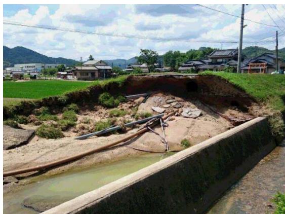
河川堤防決壊による管路破損
