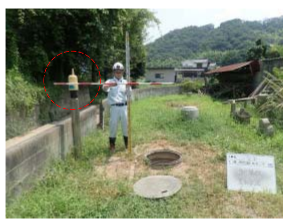
浸水による真空弁通報装置の故障
