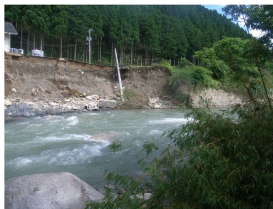
河川護岸洗掘による場内舗装の破損と引込柱の倒壊
