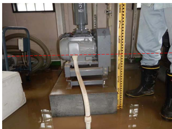
浸水によるばっ気ブロワの故障（絶縁不良）
