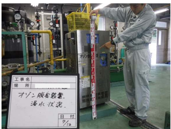
脱臭装置の浸水
