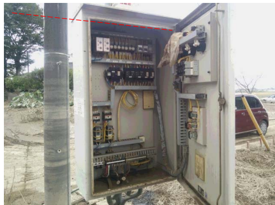
中継ポンプ制御盤の浸水（同左）
