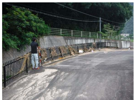
フェンスの破損
