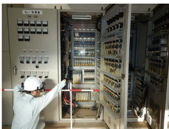
浸水による制御盤の故障
