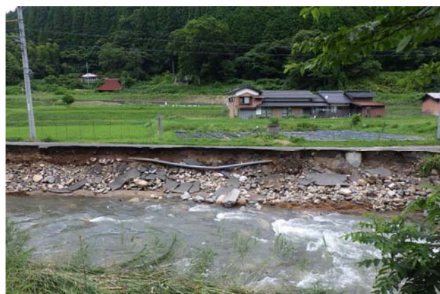
写真－６－３ 管路の被災（河川護岸が流亡し、管路が露出）
