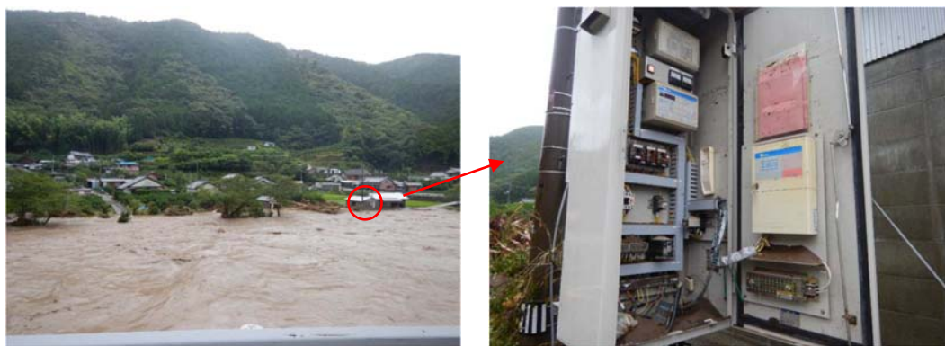
写真－６－２ 中継ポンプ制御盤の冠水
