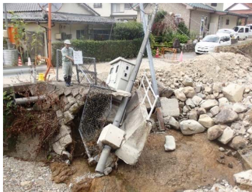
写真－3－4 中継ポンプ施設の緊急調査状況 (中継ポンプ施設の被災状況の調査)
