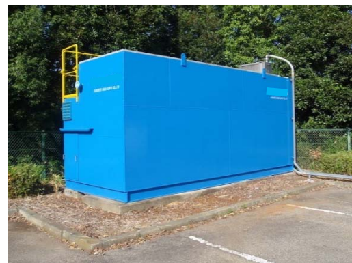
写真－４－３ ユニット型仮設処理施設
