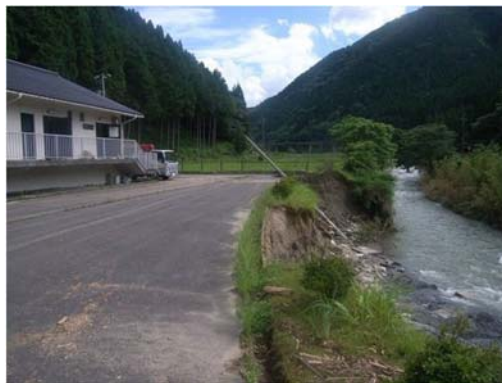
写真－３－５ 汚水処理施設周辺の河川護岸の崩壊 (立入制限措置を行う必要あり)
