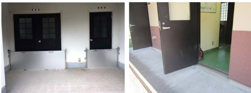
写真－６－５ 汚水処理施設扉
