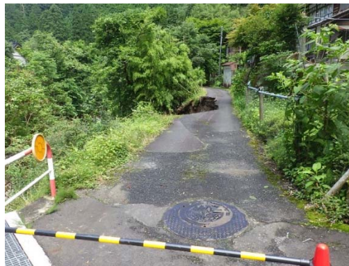
写真－３－７ 通行止め措置 (写真奥で道路が被災している)
