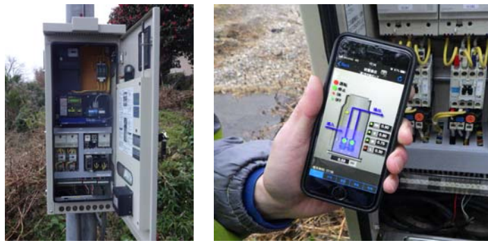
写真－６－１１ 中継ポンプ場の制御盤と遠方監視装置 (左：制御盤、右：担当者のスマートフォン（中継ポンプ場の水位情報画面）)
