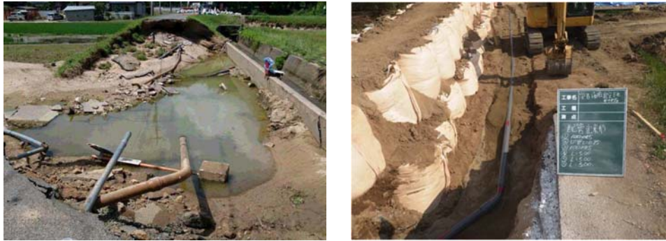
写真-4-8 左：真空用塩化ビニル管の被災、右：塩化ビニル管（RR管）での仮復旧
