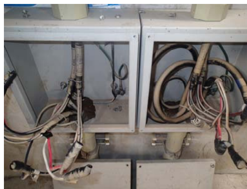
写真－６－９ 原水ポンプ配線プルボックス内結線状況 (融着テープにより水密性を確保する必要性有)
