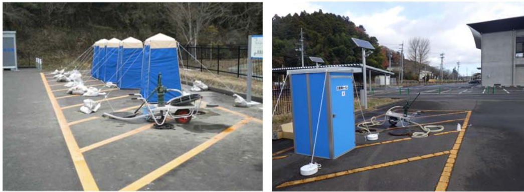
写真-6-15 宮城県東松島市（大塩市民センター）のマンホールトイレ （左：東日本大震災時のテント式、右：現在のパネル式）
