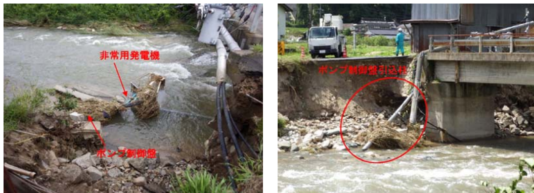
写真－６－１ 左：中継ポンプ制御盤・非常用発電機、右：引込柱の被災
