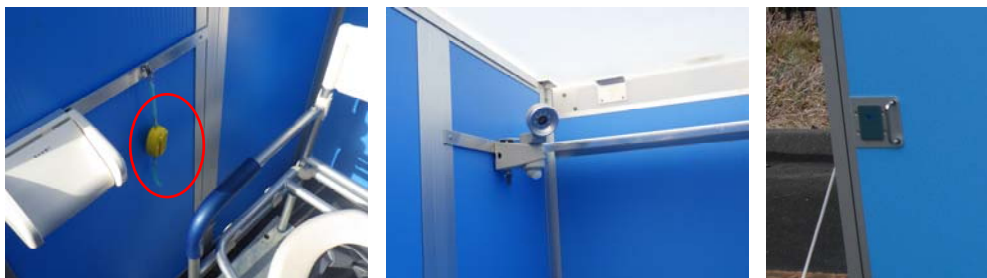
写真-6-16 安全施設（左：防犯ブザー、中：照明、右：施錠）
