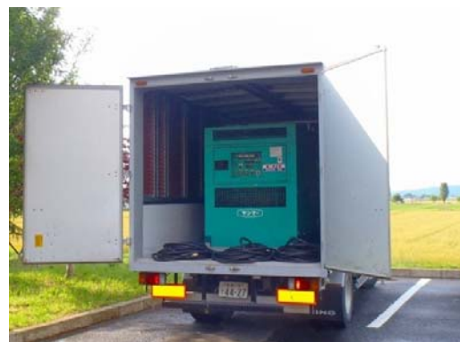
写真－３－６ 発電機搭載車
