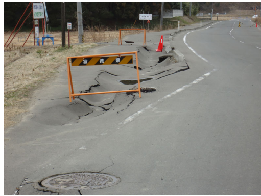
【管路施設上部の地盤沈下】
