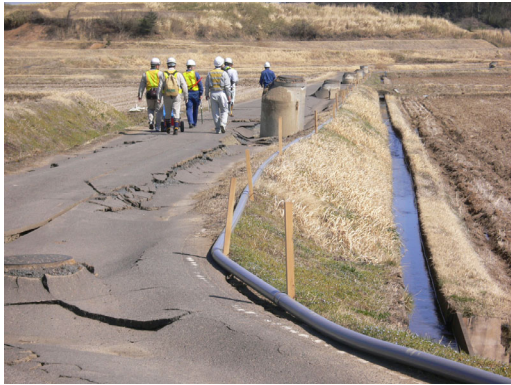
【マンホールの連続浮上】
