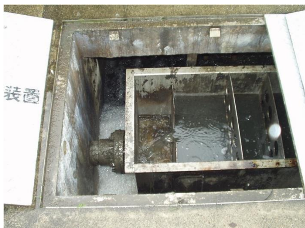
写真－3 接触ばっ気槽第2室における発泡現象
