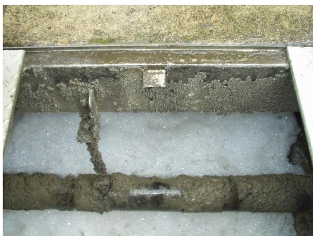
写真－2 接触ばっ気槽第1室における発泡現象
