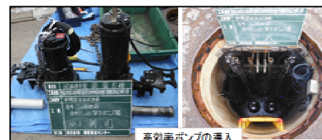
高効率水中ポンプの導入
