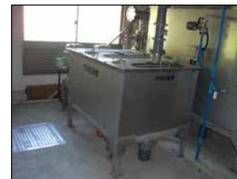
流量調整ポンプ及び污水計量槽の運転時間調整
