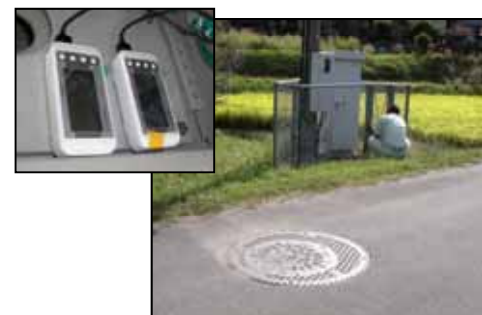
高効率水中ポンプの導入
