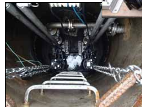
高効率水中ポンプの導入
