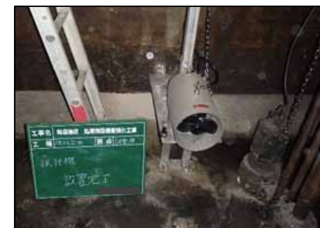
高効率攪拌装置の導入 流量調整槽攪拌装置の間欠運転
