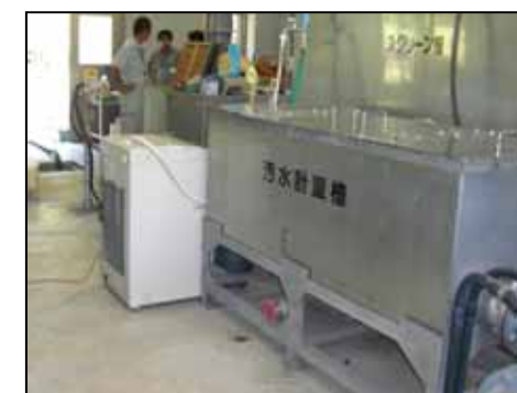
流量調整ポンプ及び汚水計量槽 の運転時間調整
