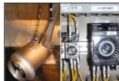
高効率攪拌装置の導入・間欠運転
