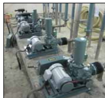
高効率Vベルトを設置するブロウ
