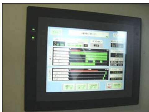
コントロールパネル
