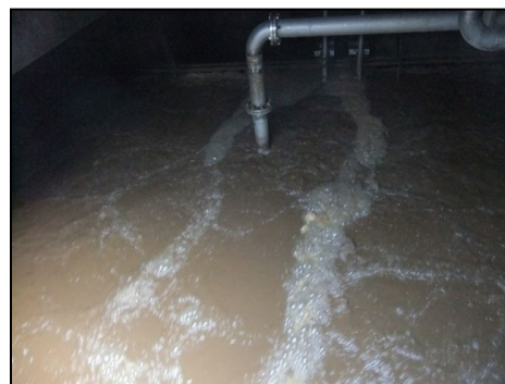
微細気泡散気装置の運転状況
