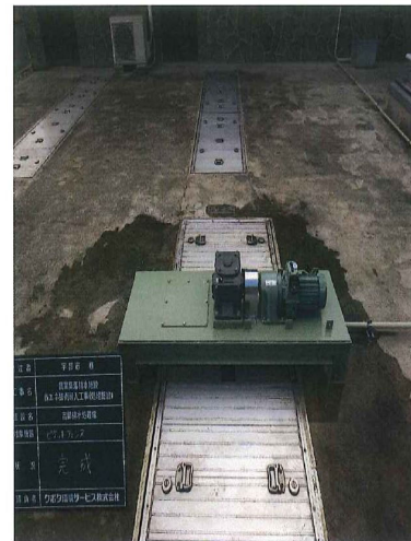
汚泥濃縮装置の駆動部
