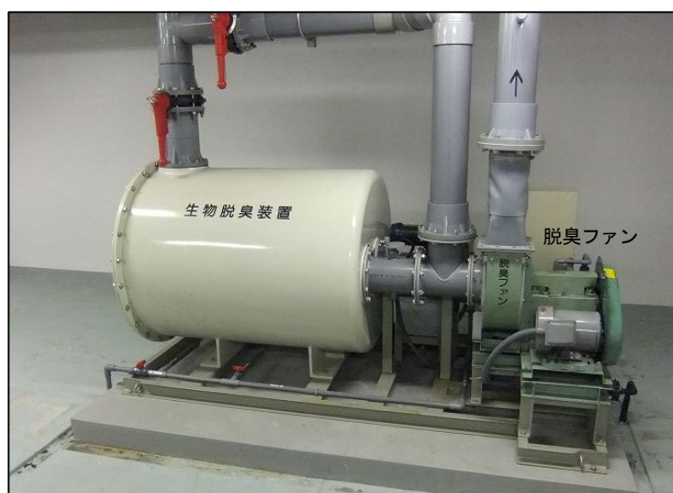
生物脱臭装置
