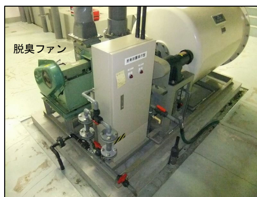
生物脱臭装置の制御盤
