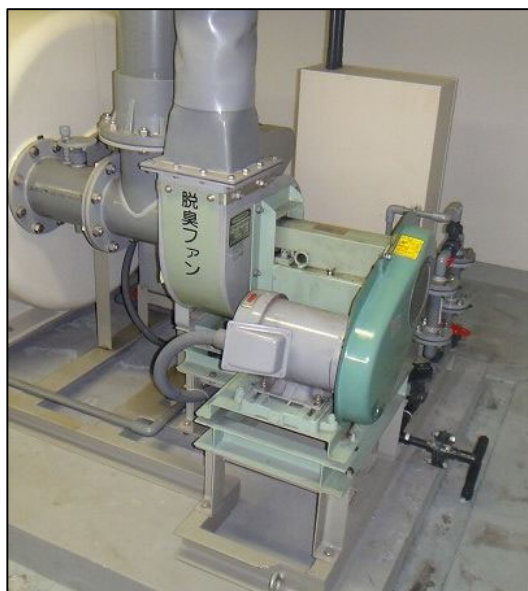
生物脱臭装置の脱臭ファン
