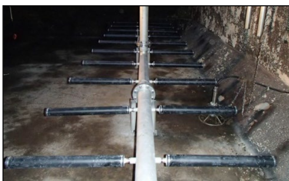
微細気泡散気装置の設置状況
