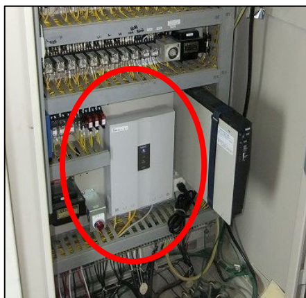
子局（遠方監視装置） （機器の運転状況監視）
