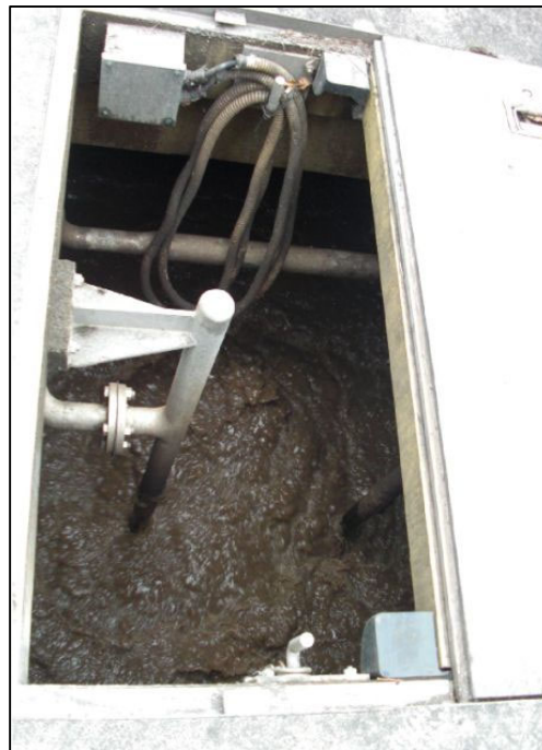
写真 3.14.5 ばっ気槽のばっ気攪拌状況
