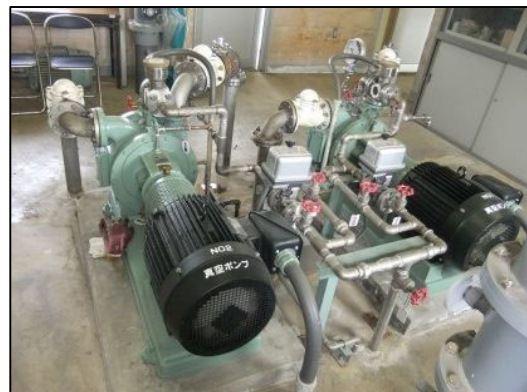
真空ポンプ（既存施設）
