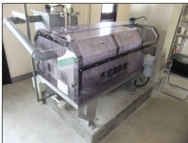
ベルト式ろ過濃縮機（ろ布式汚泥濃縮装置）
