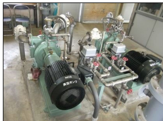
真空ポンプ（既存施設）
