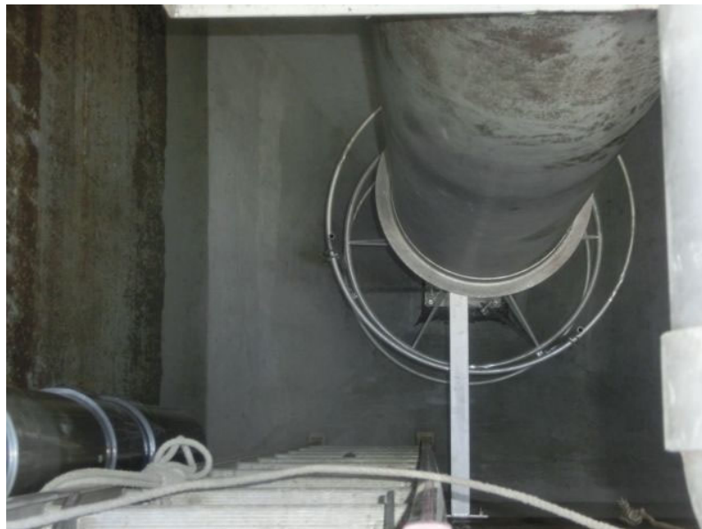
汚泥濃縮装置（回転棒（ピケットフェンス））
