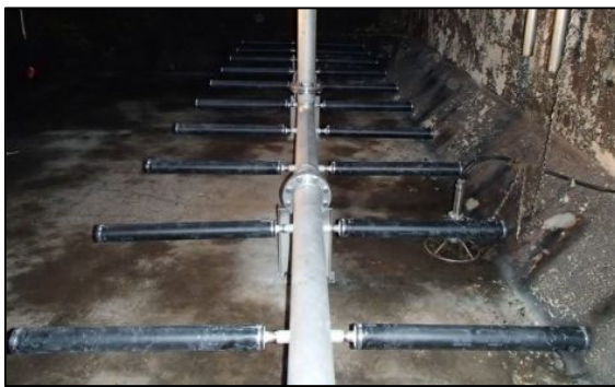
微細気泡散気装置の設置状況
