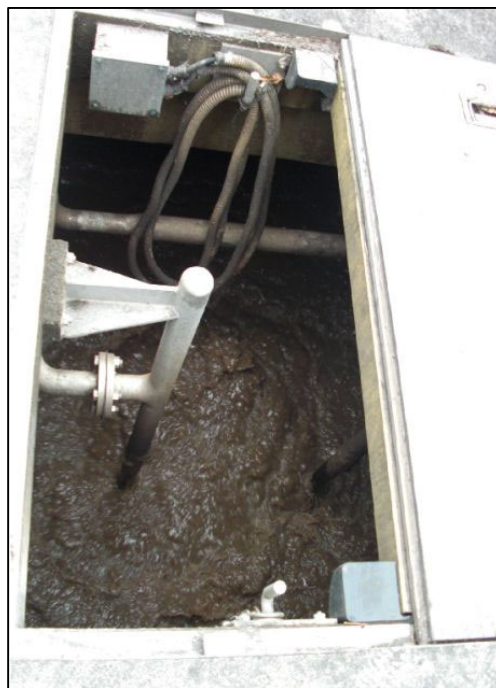
写真 3.14.5 ばっ気槽のばっ気攪拌状況
