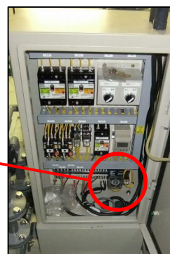
制御盤内部の状況
