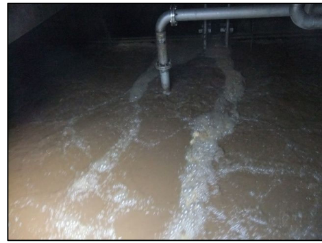
微細気泡散気装置の運転状況
