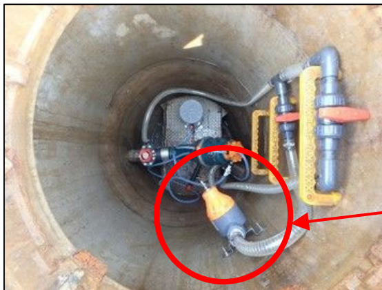
自動吸気弁の設置状況
