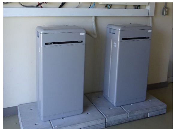
写真 1-2-10 単相蓄電池システム (岡崎市豊南地区)
