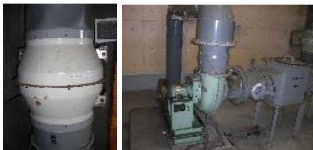
写真3-6-11 左：給気ファン、右：脱臭ファン
