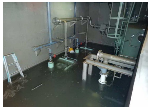
写真 2-2-2 水没した地下室(前処理室)
