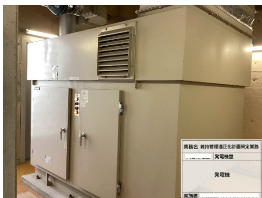
写真 2-1-1 非常用発電設備
