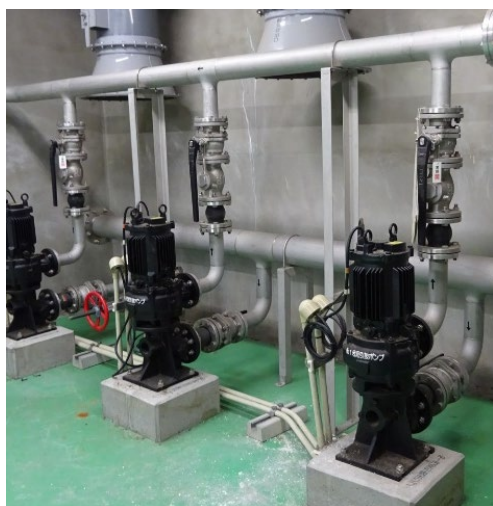
写真 3-6-9 汚泥引抜ポンプ
