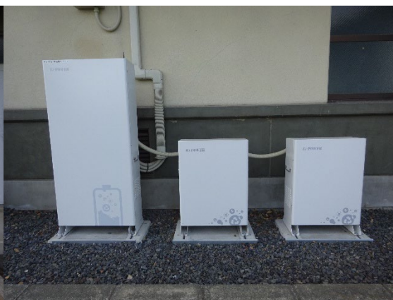
写真 1-2-4 単相蓄電池システム (太田市毛里田北地区)
