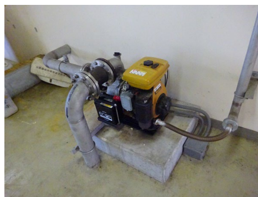
写真 2-1-2 非常用エンジンポンプ
