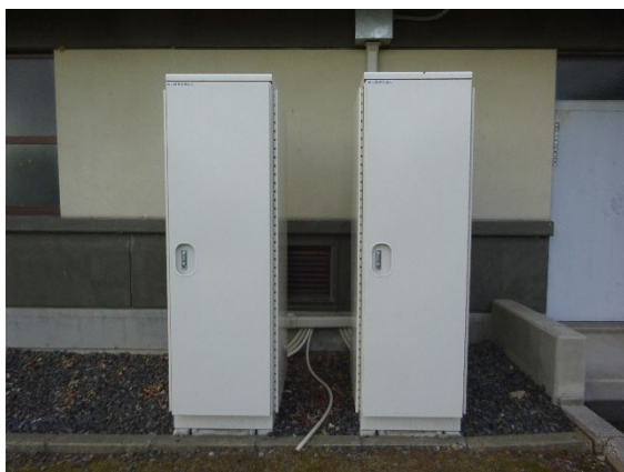
写真 1-2-3 三相蓄電池システム (太田市毛里田北地区)
