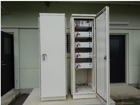
写真 1-2-7 三相蓄電池システム (美里町南部中央地区)
