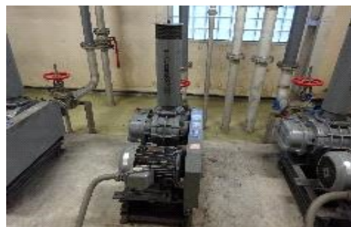
写真 3-6-14 石ろ過設備の散気ブロワ
