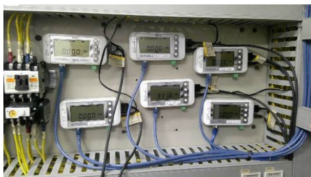
写真 3-6-1 制御盤に設置した電力量計
