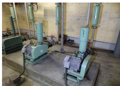
写真 3-6-8 ばっ気ブロワの全景
