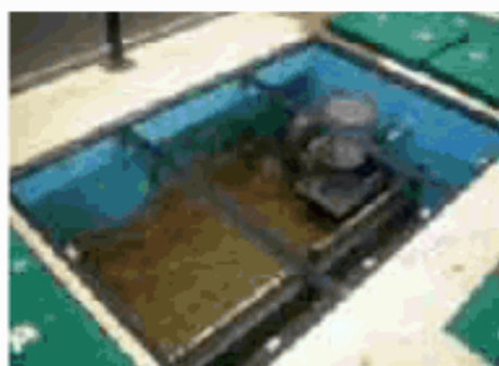
写真-1 ばっ気沈砂槽(寸法1.5m×2.0m)に、ばっ気式水中スクリーン2基、散気装置、沈砂排出ポンプ及び消泡装置が具備されている。
