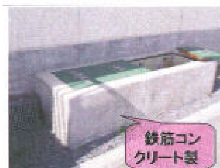
写真 11-1 RC 製の汚水計量槽
