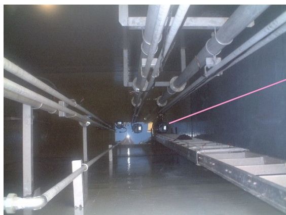
写真 3-5-1 水中汚水汚物ポンプを採用した事例
