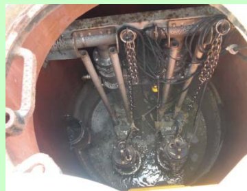
中継ポンプ場内のマンホールポンプ
