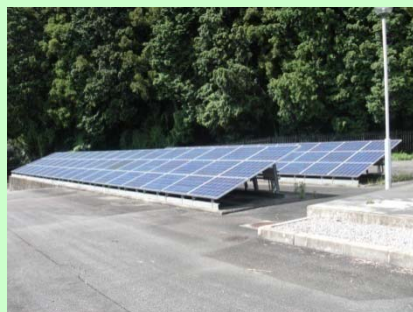
敷地内に設置した太陽光発電パネル
