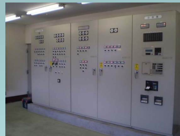
処理施設における動力制御盤
