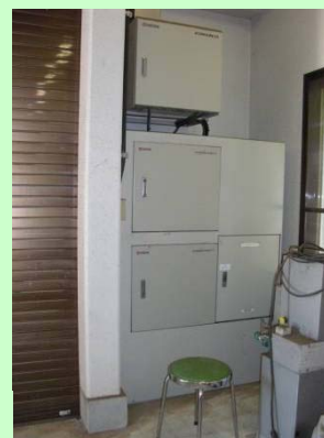
太陽光発電の制御装置
