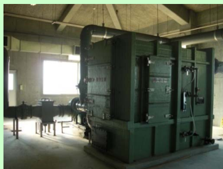
脱臭装置（活性炭吸着方式）
