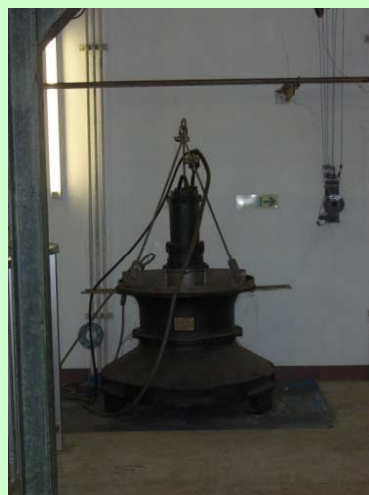
既存の機械式 ばっ気攪拌装置
