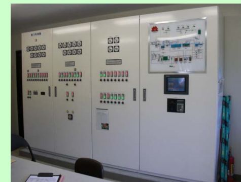
処理施設における総電力消費量を確認
