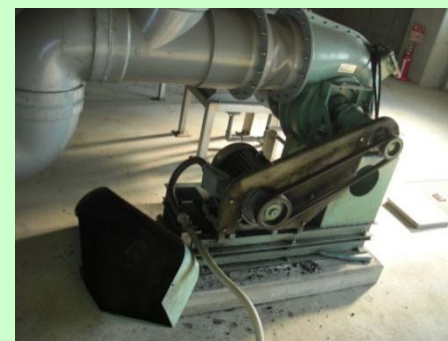
脱臭ファン装置
