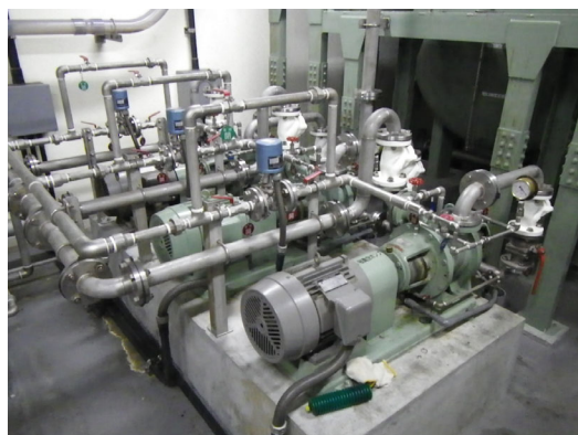
真空ポンプ状況
