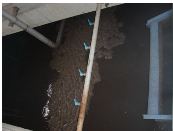
写真 4.3.1 回分槽の全景
