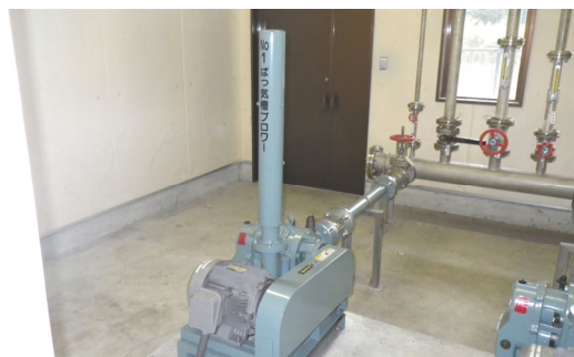
電力量測定対象施設（NO.1 ブロワ）
