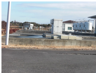
OD 槽の全景
