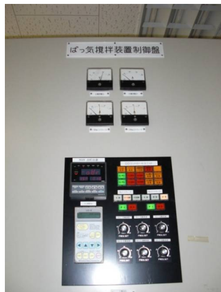
写真 5.4.3 ばっ気攪拌装置の DOコントロールユニット
