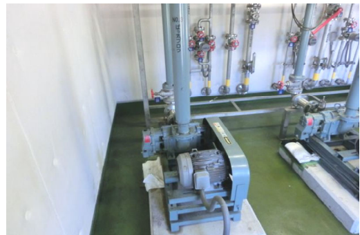
電力量測定対象施設 (NO.3 ブロワ 3.7kW)
