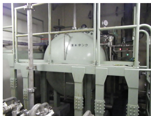
集水タンク状況
