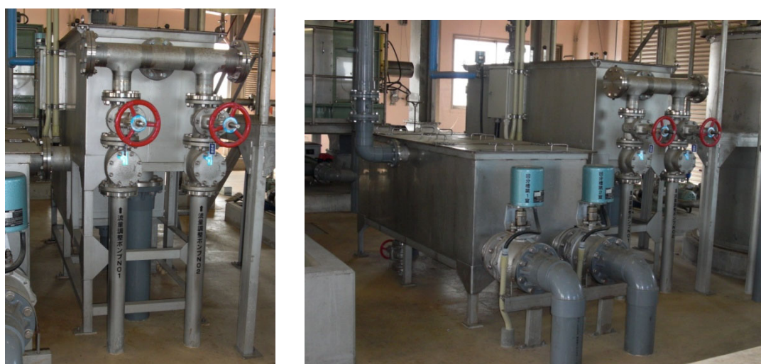
写真 5.2.1 流量調整ポンプのスラブ上部配管（左写真）及び汚水計量槽（右写真）
