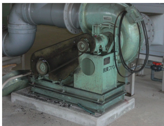
写真 5.5.1 脱臭装置及び脱臭ファンの設置状況
