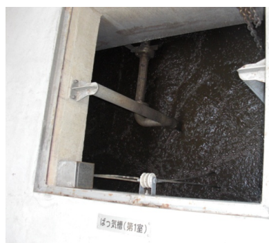
ばっ気槽第1室 状況
