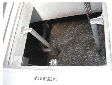
ばっ気槽第2室 状況
