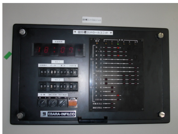
写真 4.3.2 回分槽コントロールユニット
