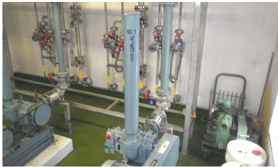
電力量測定対象施設 (NO.1 ブロワ 3.7kW)
