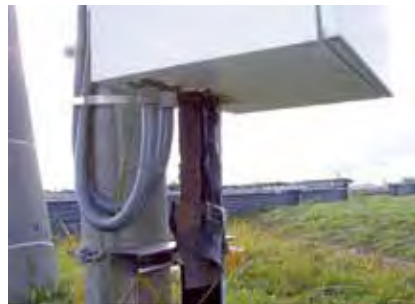
中継ポンプ制御盤劣化状況
