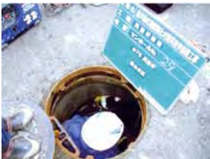
新型真空弁設置状況
