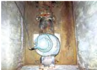
処理施設 破碎機劣化状況
