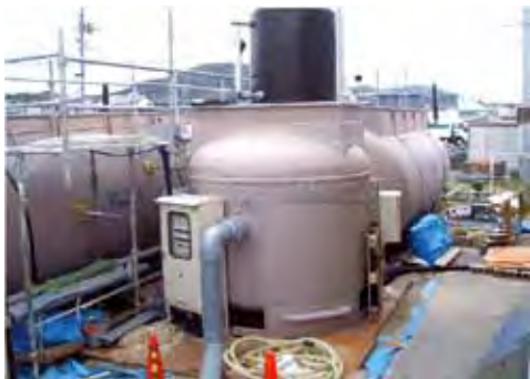
仮設膜処理ユニット設置
