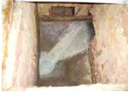
処理施設 移流水路劣化状況
