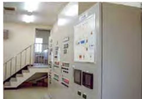
動力制御盤（新設）
