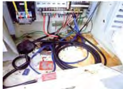
中継ポンプ制御盤劣化状況
