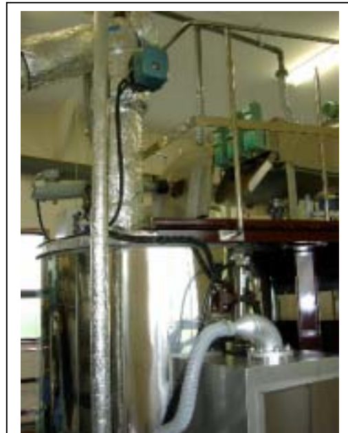
主要機器 (発酵機・缶体部)
