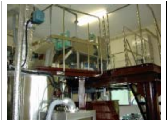
主要機器 (脱水機・脱水機架台)
