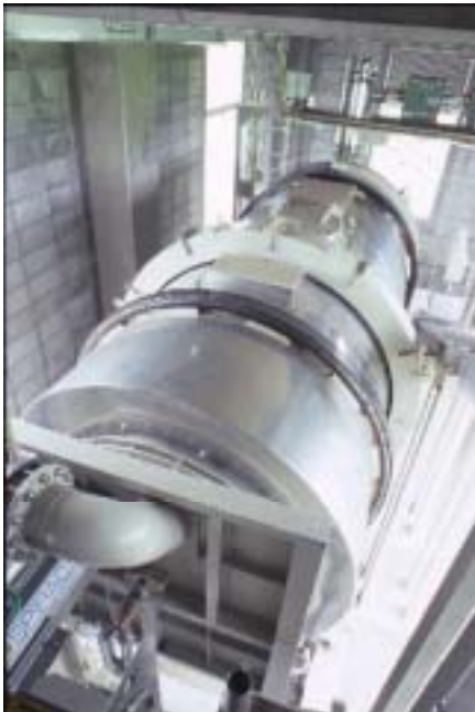
主要機器 一次発酵槽
