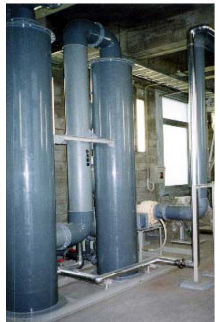
主要機器 脱臭装置
