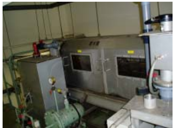
主要機器② (脱水機)
